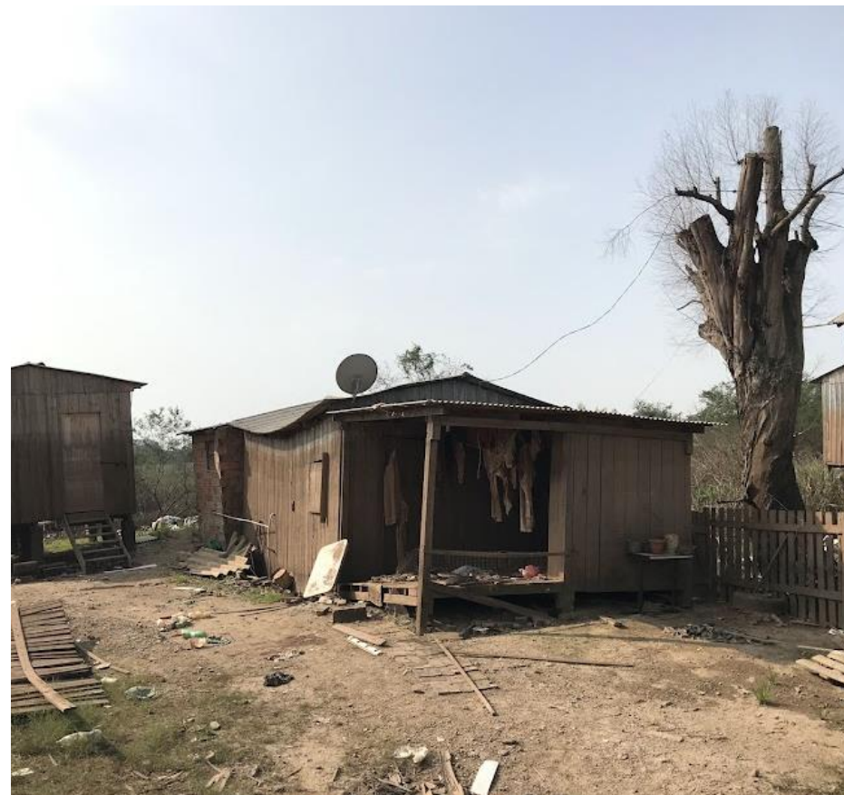
Figura 81 – Edificação situada na Ilha das Flores, cerca três meses após o desastre hidrológico de maio-abril de 2024. 344
